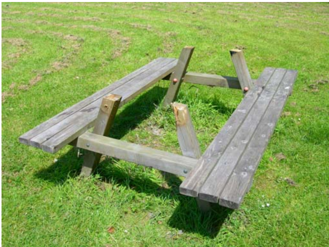
Vandalisme op het recreatie steunpunt
